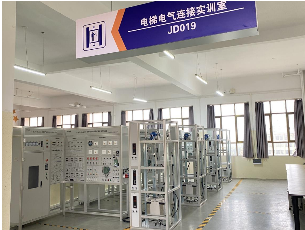
图 7.9 电梯电气连接实训室
